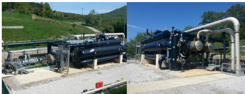
Figure 6: Gruppo Binario Bagnore (1MW) power plant.
